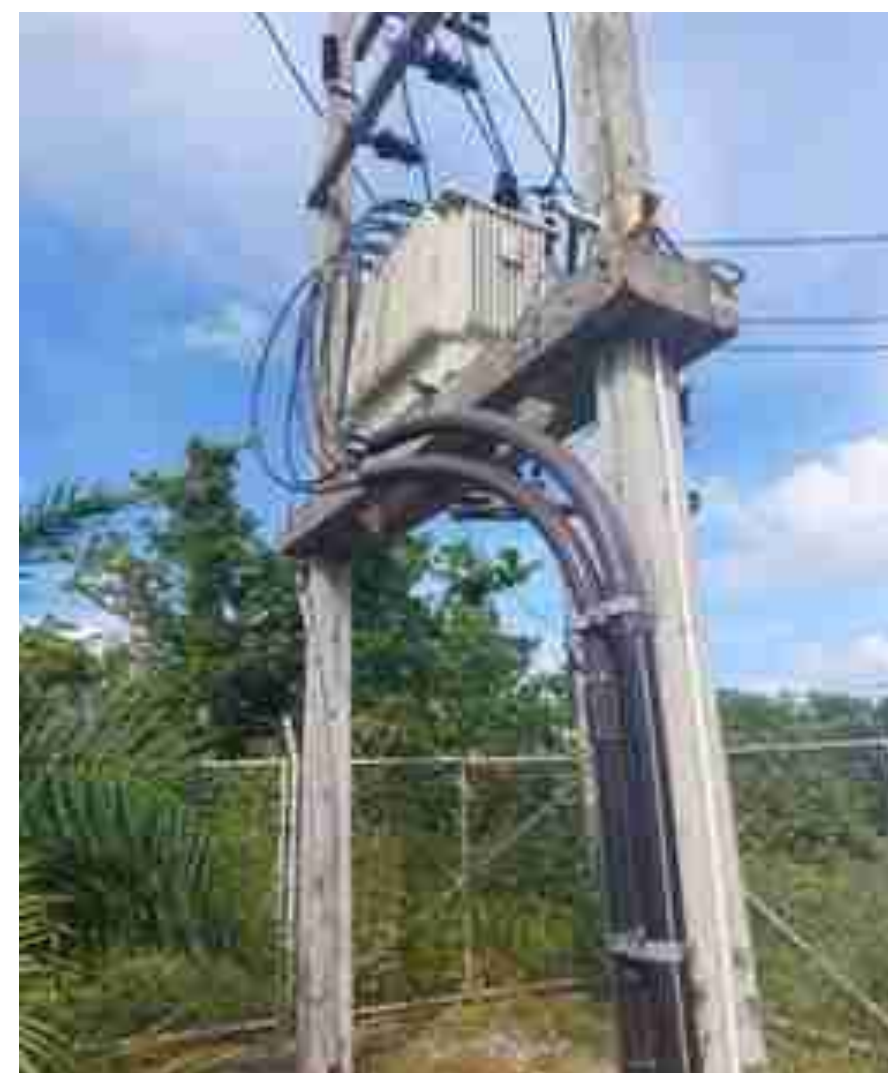
แสดงรูปหม้อแปลงไฟฟ้า ณ จุดติดตั้งกังหันลม เกาะเต่า
